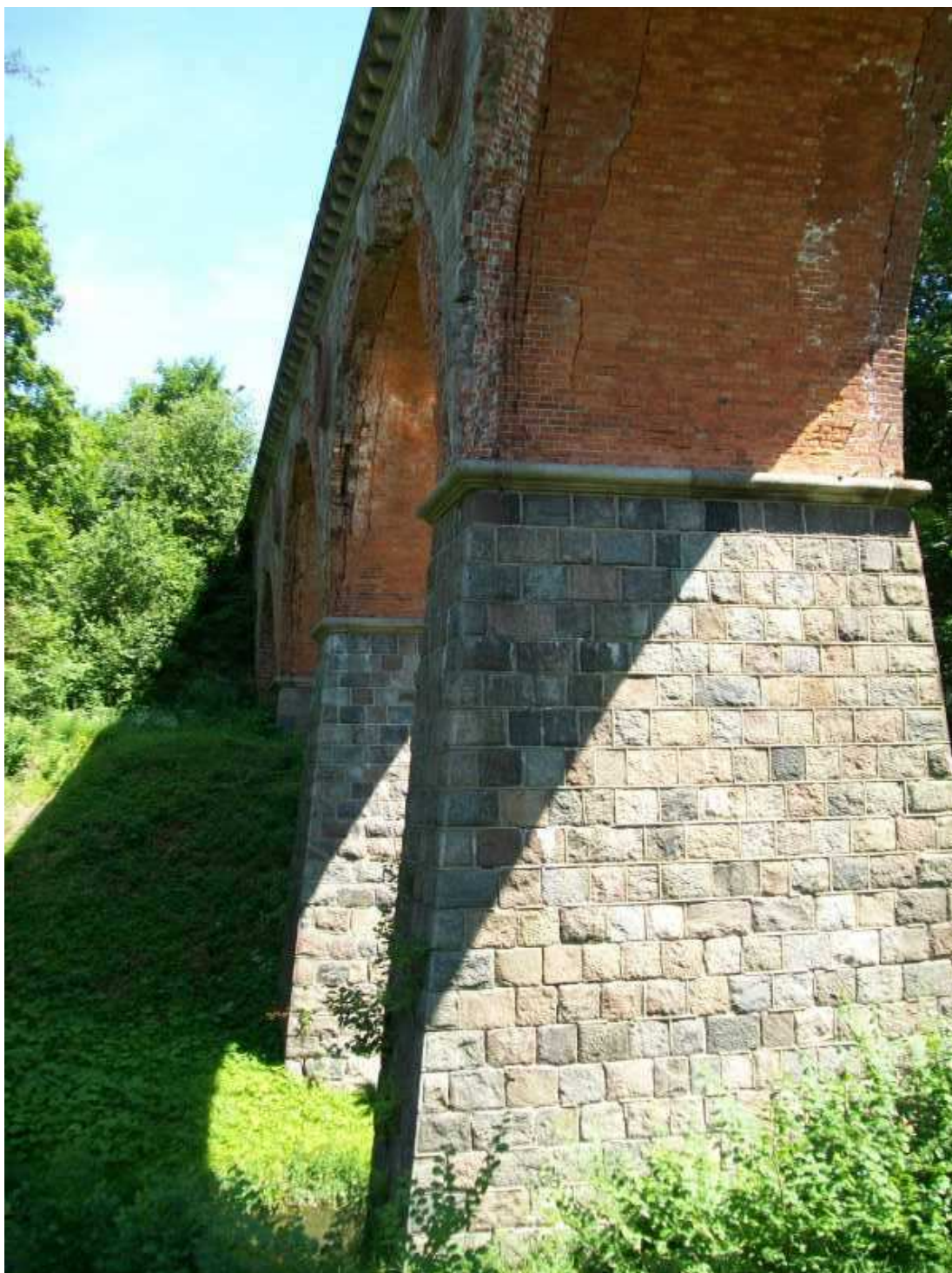
Fot.7. Pęknięcia podłuczy i rozejścia wątku
