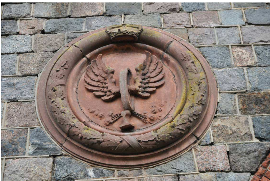
Fot.9 Medalion z emblematem kolei, widoczny ubytek korony
