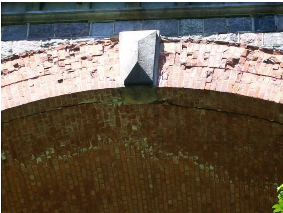
Fot.3 Fragment łuku, widoczne zasolenie podłucza i rozchodzenie się muru podłucza i obmurowania krawędzi łuku
