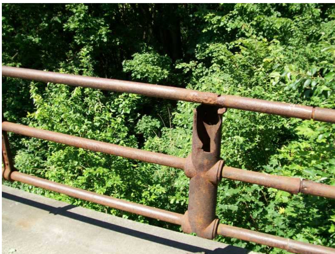
Fot. 14 Przykład uszkodzenia słupka
