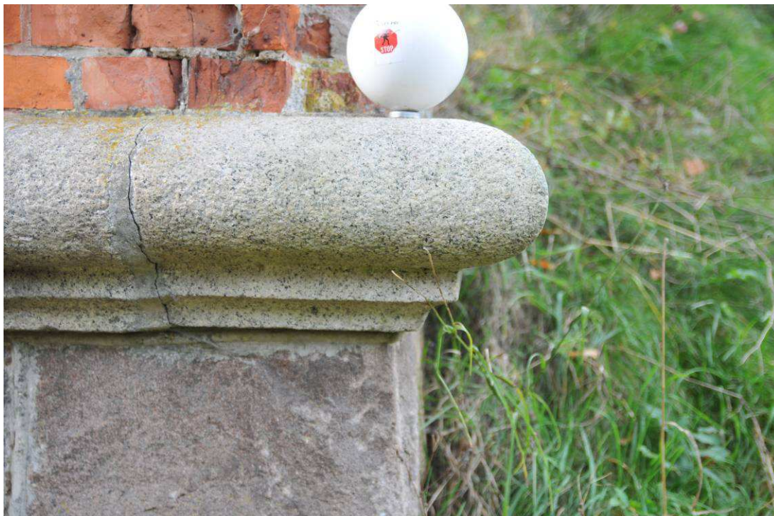
Fot.8 Pęknięcie granitowego gzymsu
