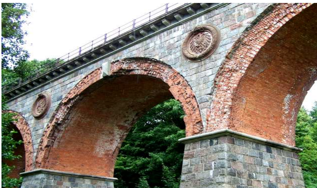
Fot.2 Fragment elewacji zachodniej, widoczne białe wykwity solne i głęboki, rozległy ubytki obmurowania łuków.
