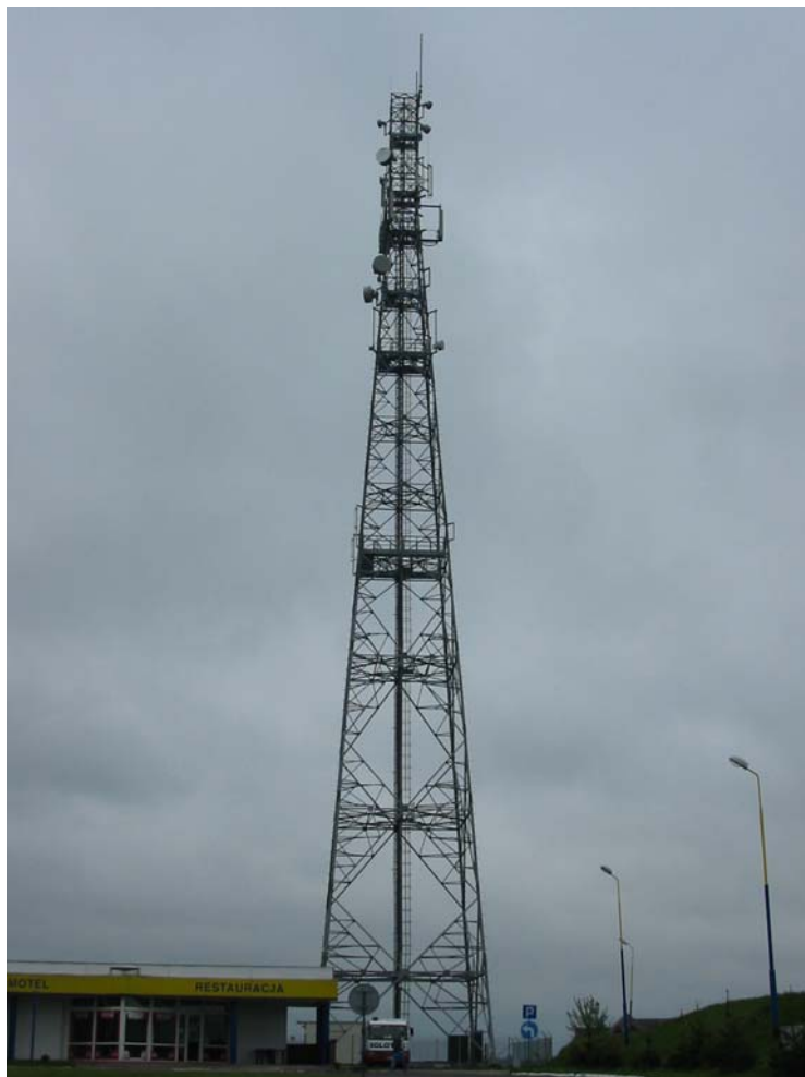
Fot. 1 Stacja nadawczo-odbiorcza sieci telefonii komórkowej
